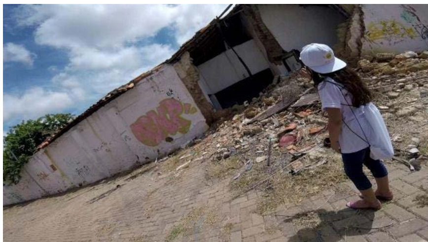
Figura 3: Casa em ruína
