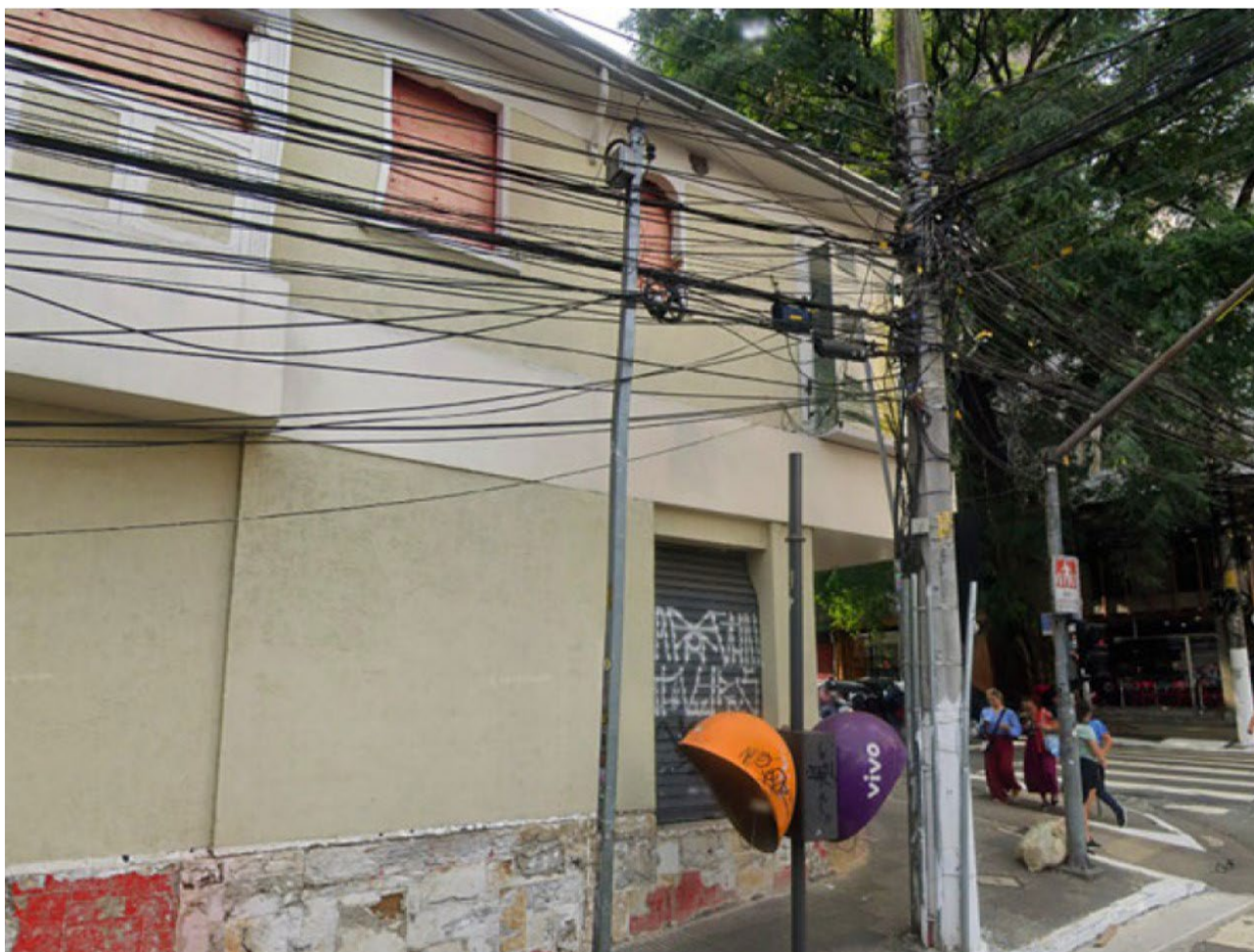
Figura 8 - Foto mostrando a precariedade e o perigo dos postes elétricos – porém funcionais – em São Paulo.
